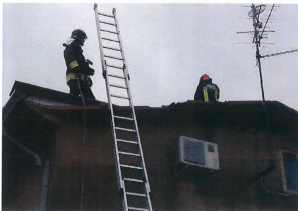
Vigili del fuoco al lavoro: il vento e la gradine hanno scoperchiato il tetto di una casa
